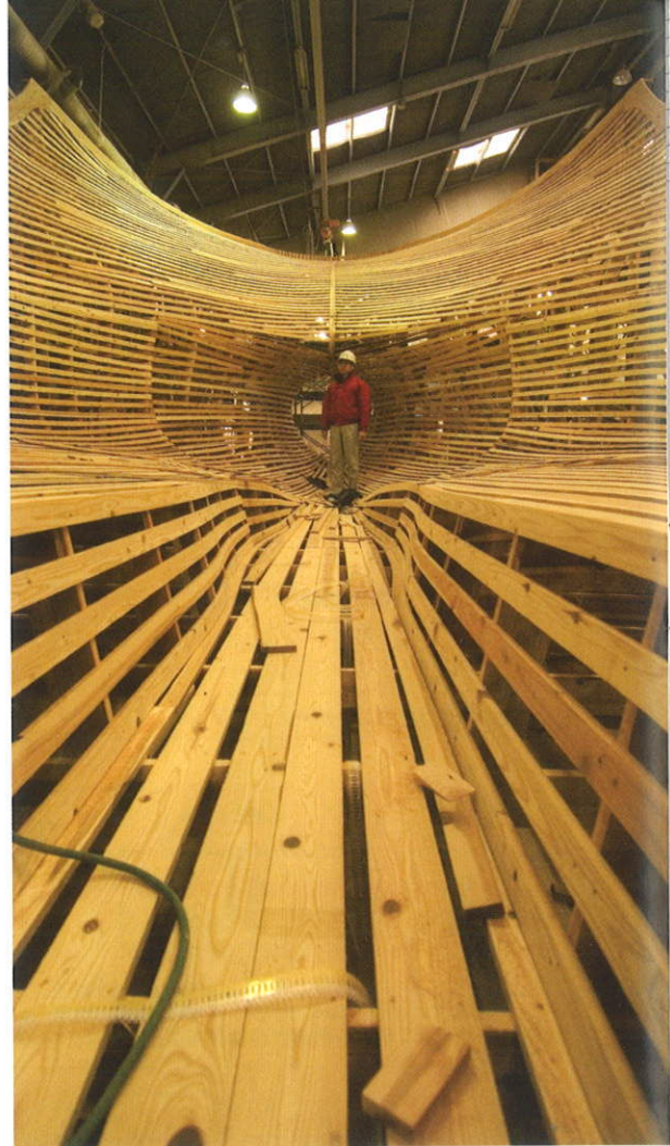
底曳網漁船などの大型船造りは木職人による成形から始まる
